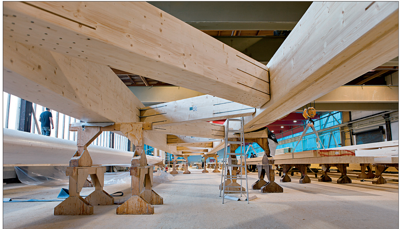
Vorfertigung in anderen Dimensionen: Unter der Bekleidung der flügelähnlich geformten BSH-Holzträger verbergen sich Fachwerkbinder. Die Knoten sind mit Schlitzblechen und Stabdübeln verbunden. Foto: Derix/Poppensieker & Derix
